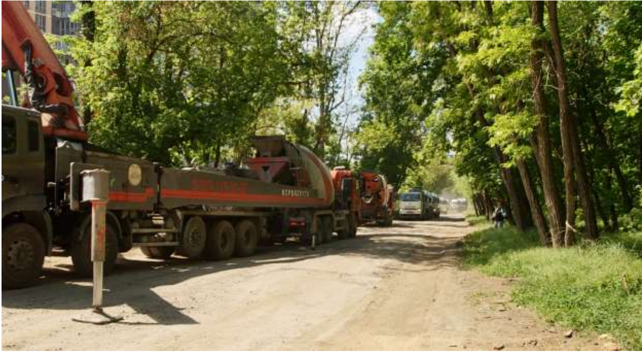
Рис. 5. Рабочая площадка АБН 2
