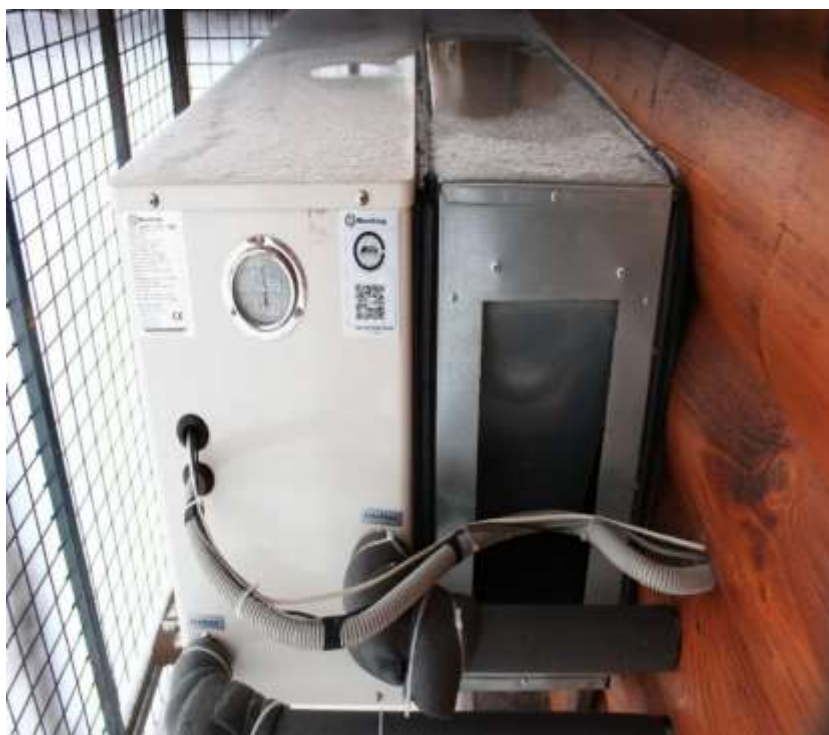
Рис. 6. Камера смешения воздуха [15] и ВТН, установленные в малоэтажном жилом здании в Ивановской области
